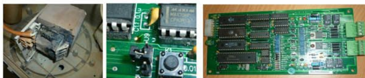
内部整流器被雷电流烧坏
